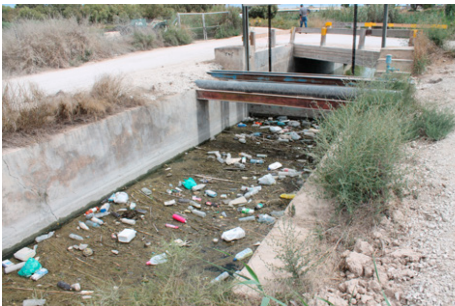
Estado de los azarbes en Guardamar, 2022.
